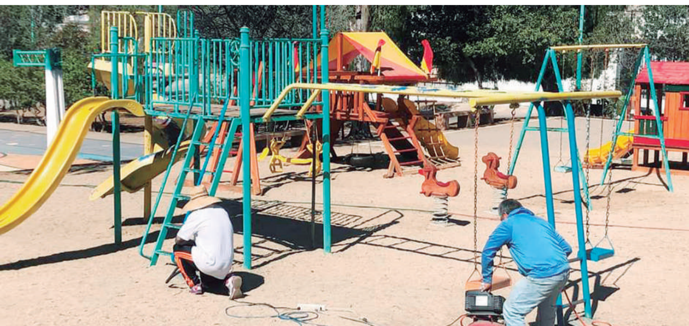
TECATE.- Las paredes grafiteadas y dañadas se han repintado, reparados los juegos infantiles y áreas verdes.
