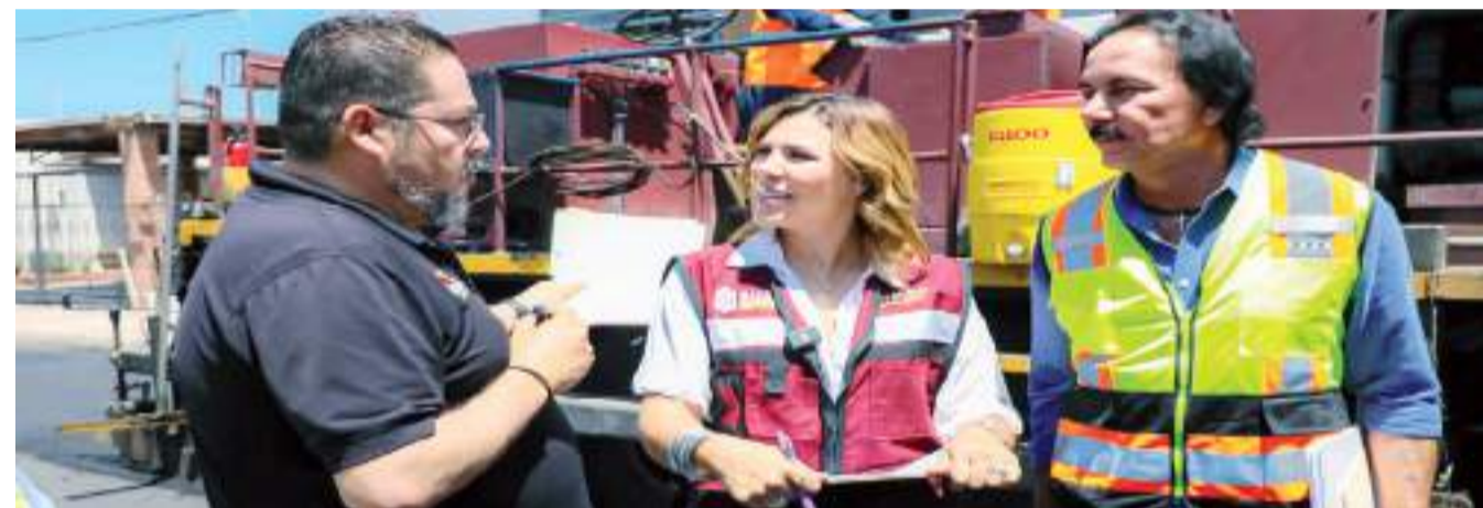
La mandataria estatal comentó que esta pavimentación es un esfuerzo en conjunto entre la Secretaría de Infraestructura, Desarrollo Urbano y Reordenación Territorial, la Junta de Urbanización, así como las y los habitantes de la colonia Independencia.
