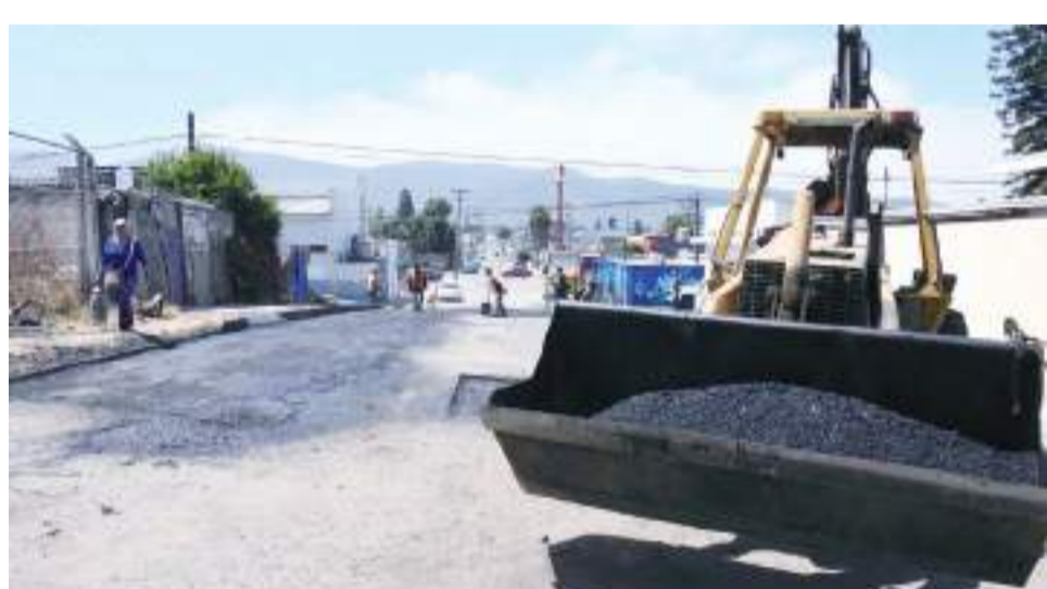
ENSENADA.- Rehabilita el Gobierno Municipal más de 3 mil metros cuadrados de vialidades en la colonia Hidalgo, con la aplicación de mezcla asfáltica, trabajos en los que se invierten alrededor de 2 millones de pesos.
