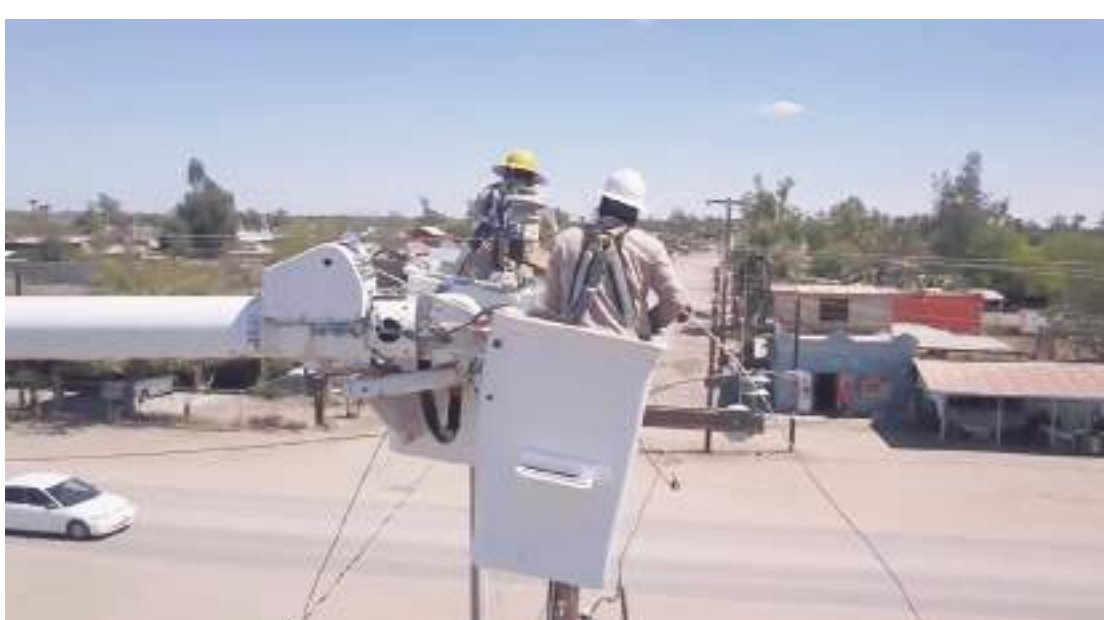
MEXICALI.- La CFE trabaja en mejoras para garantizar el suministro de energía en la temporada de verano, cuando la demanda se incrementa.
