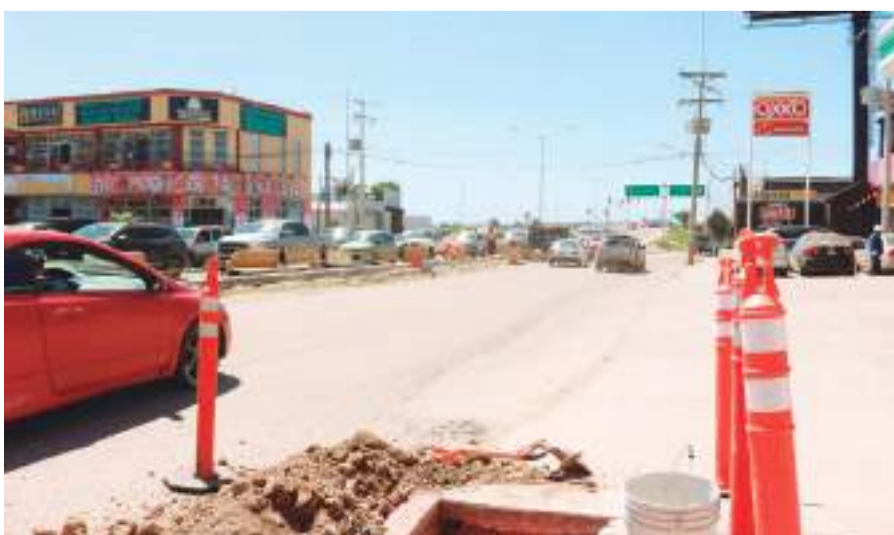
PLAYAS DE ROSARITO.- Exhortan a tomar tiempos y precauciones al transitar por el Puente Machado, debido a que se realizan trabajos de mantenimiento.
