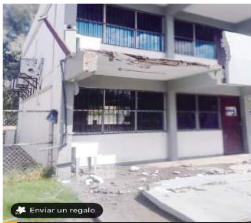
MEXICALI.- Al caer una parte de la barda perimetral del segundo piso de uno de los edificios de la escuela primaria Benito Juárez, la Secretaría de Educación ordenó la suspensión de clases.
