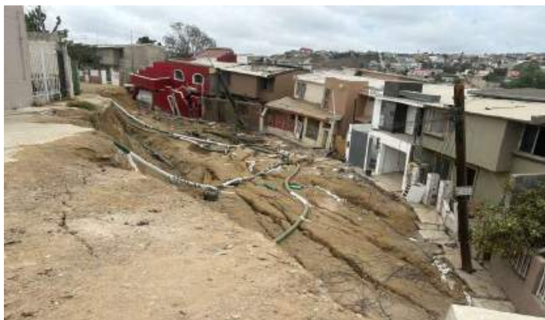
TIJUANA.- La estructura de las casas continúa cediendo ante los deslizamientos y los vecinos temen que éstos alcancen la parte superior.
