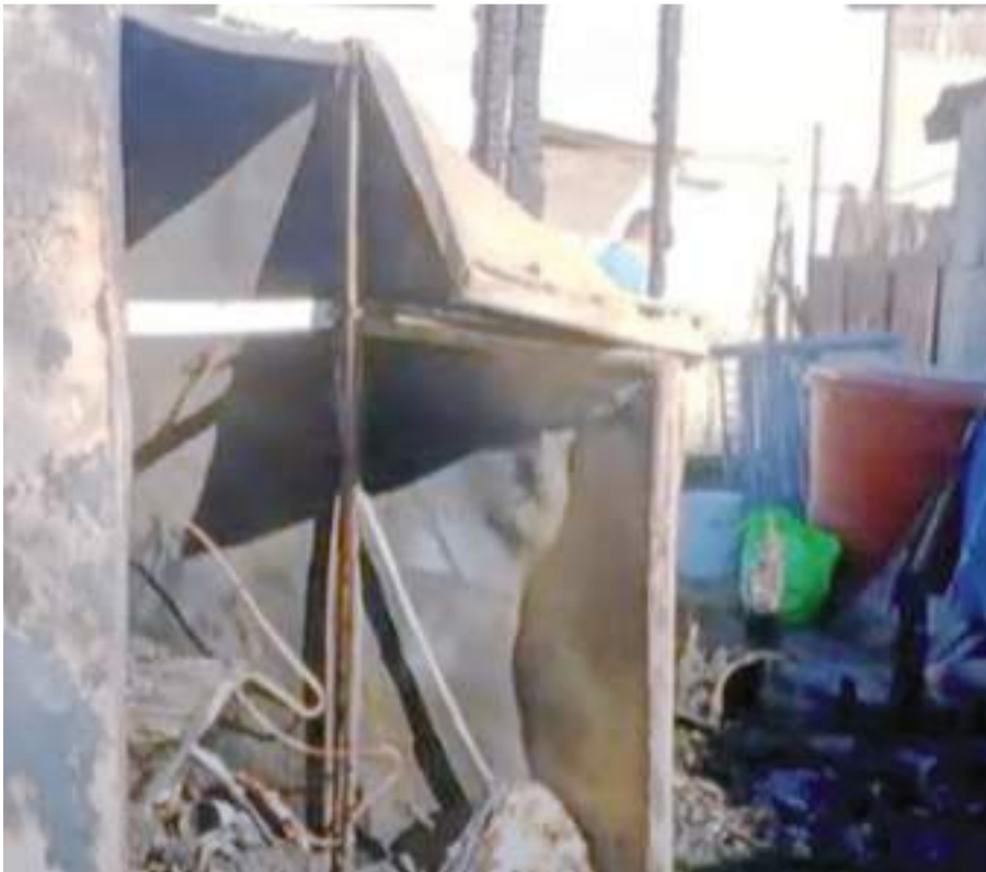
ENSENADA.- La casa de la familia Castillo Alejandrez fue consumida por el fuego en un incendio el pasado viernes, ahora piden ayuda.
