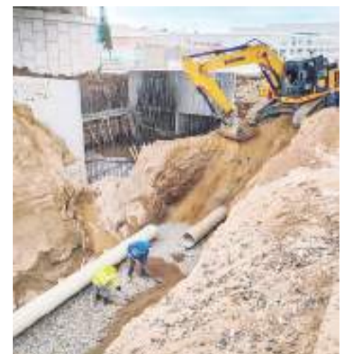
ENSENADA.- Con obras de introducción de red de agua potable durante el 2024, la CESPE incrementa cobertura de este servicio.
