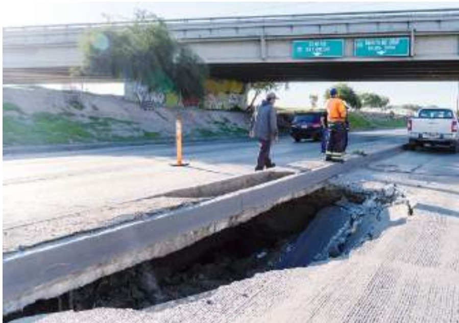
TIJUANA.- Un socavón fue localizado sobre el carril lento de la Vía Rápida Oriente, específicamente en la tercera etapa del Río Tijuana, en sentido del Florido a la Zona del Río.
