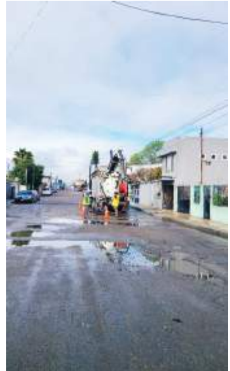
TIJUANA.- No se han registrado afectaciones en las redes primarias de colectores y subcolectores de alcantarillado sanitario de la ciudad debido a las lluvias.
