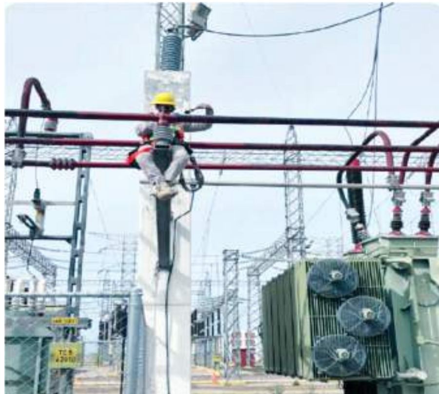
CIUDAD DE MÉXICO.- La CFE ha programado 65 nuevos proyectos para ampliarla y modernizar la red de transmisión, con una inversión estimada de casi 2,286 millones de dólares. Se ejecutarán durante la presente administración.
