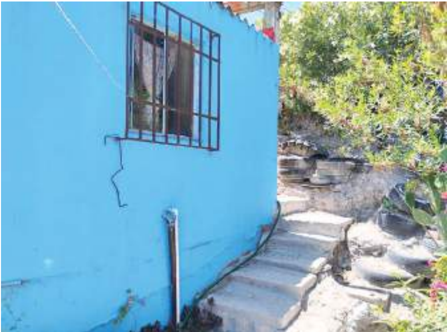
TIJUANA.- Protección Civil Municipal colocó 15 engomados rojos en viviendas y cuatro engomados más en amarillo, en zona de riesgo de la colonia Sánchez Taboada.
