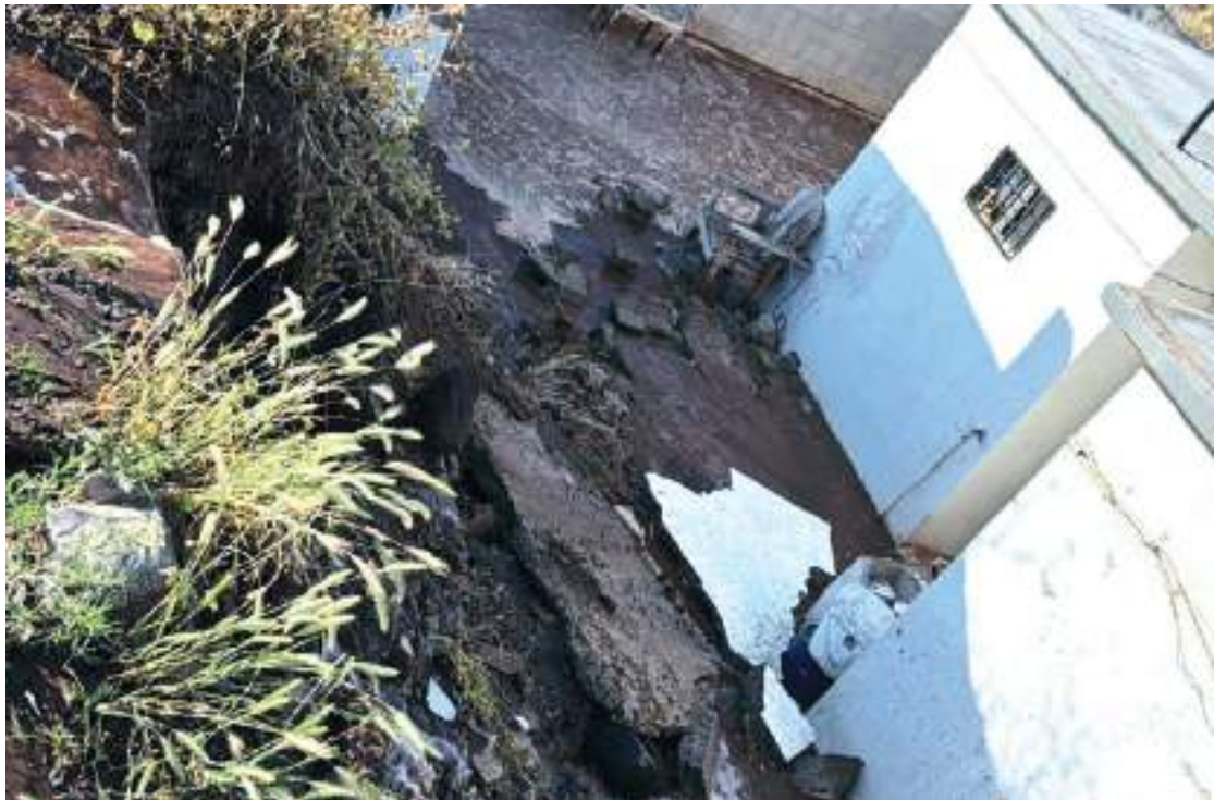
ENSENADA.- En un plazo de tres semanas se estarán solventando los daños.
