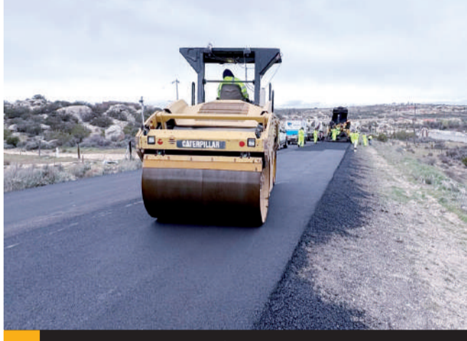
TIJUANA.- Arrancó en Baja California el programa de Conservación de Carreteras Federales.
